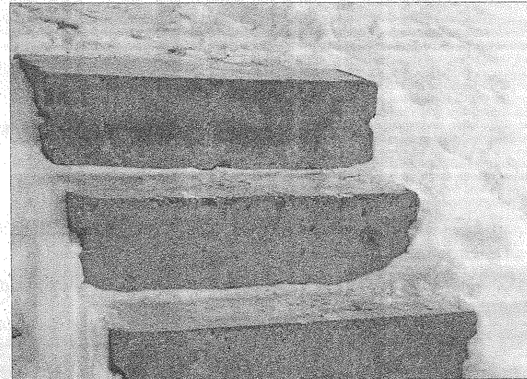
Ein abschüssiger Zugang zur Toilette, zugeschneite Treppen und Eis: Der Sturz einer Urlauberin ist nicht auf eigenes Verschulden, sondern auf die Fahrlässigkeit des Liftbetreibers zurückzuführen, befand das Gericht.
